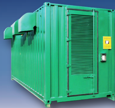
太陽能案場升壓站
